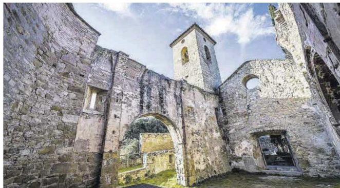
Imatge interior del temple, encara sense la coberta, que es va malmetre durant la Guerra Civil
