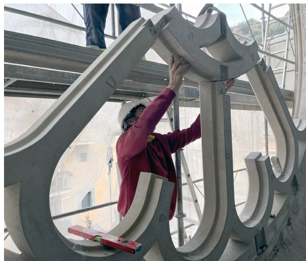
Obres de substitució de la rosassa i reforma de la torrassa a càrrec de Recop.
