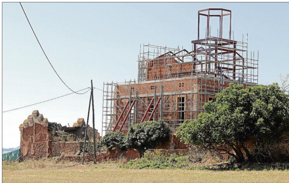
Vista de la torre Lluvià amb la bastida i, al capdamunt, l'estructura corresponent a la torrassa
