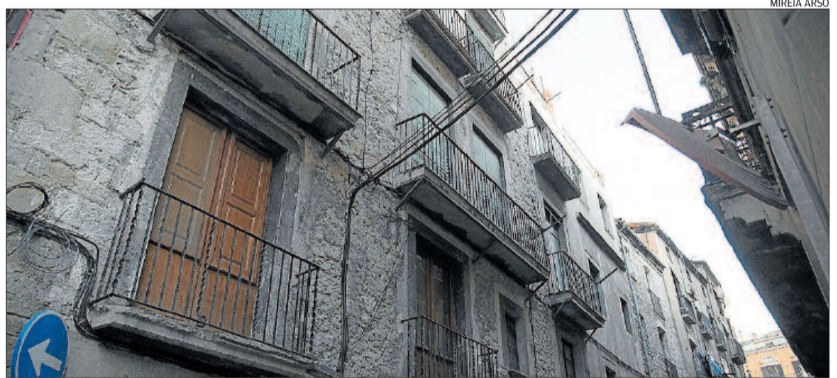
Les cases del carrer de les Piques entre la Baixada Bastardes i la plaça d'en Creus necessitaven actuacions urgents
